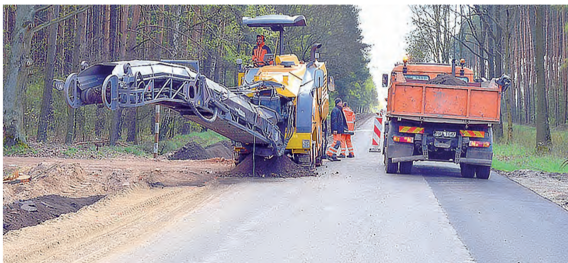
Prawie na całym odcinku droga została już poszerzona do sześciu metrów. Obecnie trwa frezowanie drugiego pobocza, które również zostanie wzmocnione.
