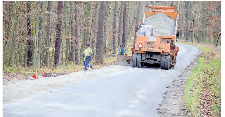
▲ Jeden z frontów robót realizowany jest w doskonałym tempie przez spółkę Colas Polska na wyłączonym obecnie z ruchu odcinku Włoszakowice-Zaborówiec.
